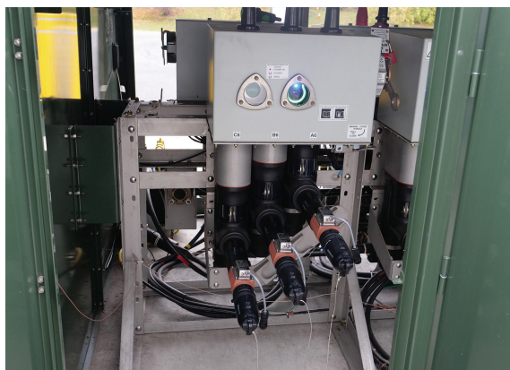
Plataforma subterrânea com produto instalado (VS-27-UG)
