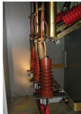
Sensor de tensión de 24 kV instalado en una aplicación de conmutación
